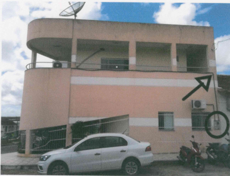
Figura 3: indica local onde será feita instalação de novo quadro de medição, como também indica eletrodutos a serem removidos.
