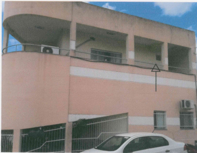
Figura 1: Indica tubos que deverão ser pintados.
